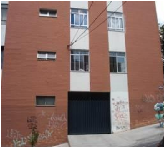
Fotografia 28: Vista da fachada que dá para a Rua General Ataulfo. Notar partes das esquadrias de janela em alumínio, no apartamento do autor, convivendo com as antigas em ferro.
