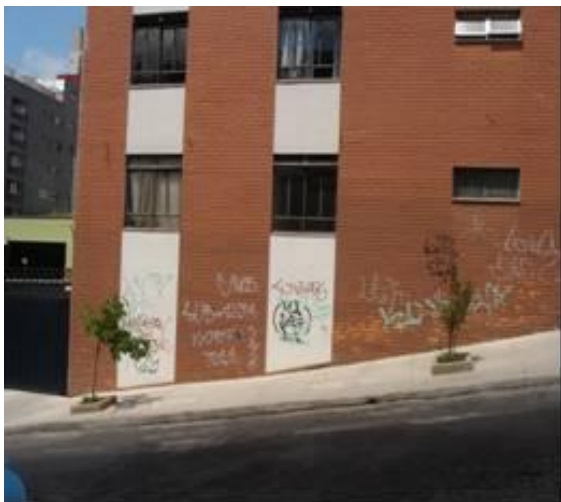
Fotografia 29: Outra vista de parte da fachada do Edifício Manaus que dá para a Rua General Ataulfo, mostrando: revestimento de fachada em litoceramica parcialmente decomposto e esquadrias de ferro. Fonte: acervo técnico do autor
