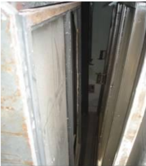
Fotografia 25: Vistas das esquadrias antigas com processo de corrosão em curso Fonte: acervo do autor.
