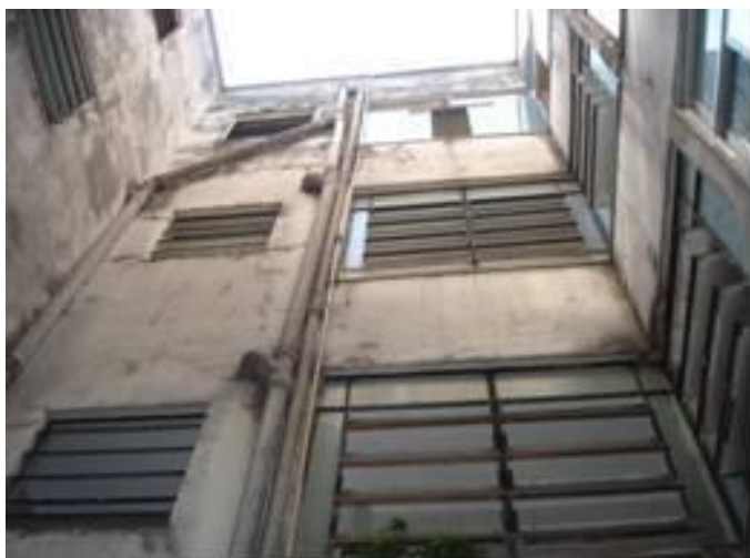
Fotografia 26: Vista do revestimento da fachada do Edifício Manaus na área de ventilação e iluminação, tomada do apartamento 106. Notar o péssimo estado do reboco, que está deteriorado em diversos locais.
