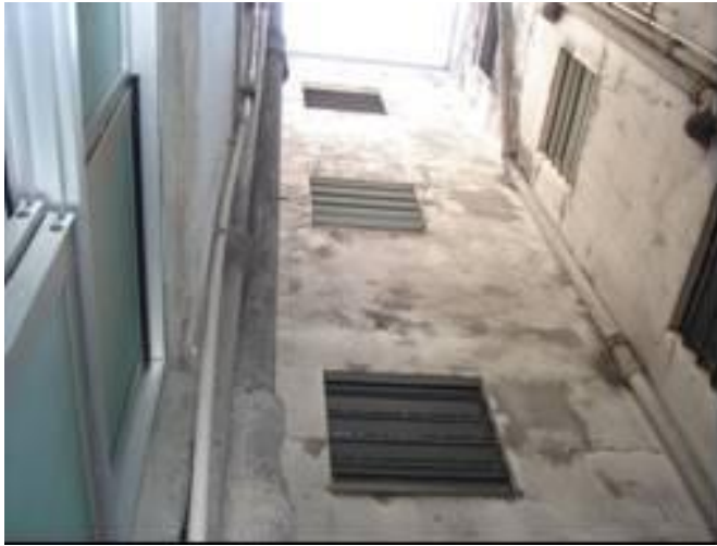
Fotografia 27: Outra vista da mesma situação. Notar tubulações antigas em ferro fundido que não vêm recebendo a devida manutenção.
