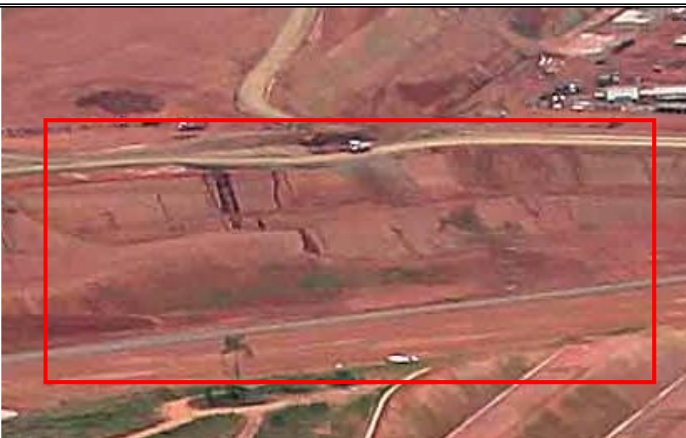
FOTO Nº 04 DETALHE AMPLIADO DA FOTO DE Nº 03 SUPRA MOSTRANDO PROBLEMAS NOS TALUDES DO ACESSO 01 ANTES DE QUALQUER OBRA DE PAVIMENTAÇÃO
