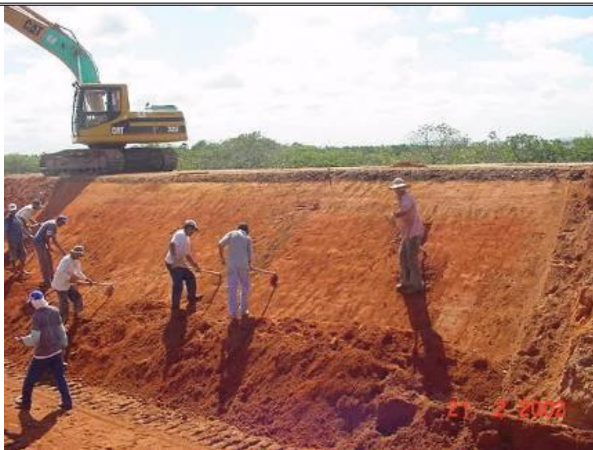
FOTO Nº 01 REMOÇÃO MANUAL DE MATERIAL SOLTO NAS EXTREMIDADES DE ATERRO DEVIDO A COMPACTAÇÃO INSUFICIENTE NESTAS ÁREAS.
