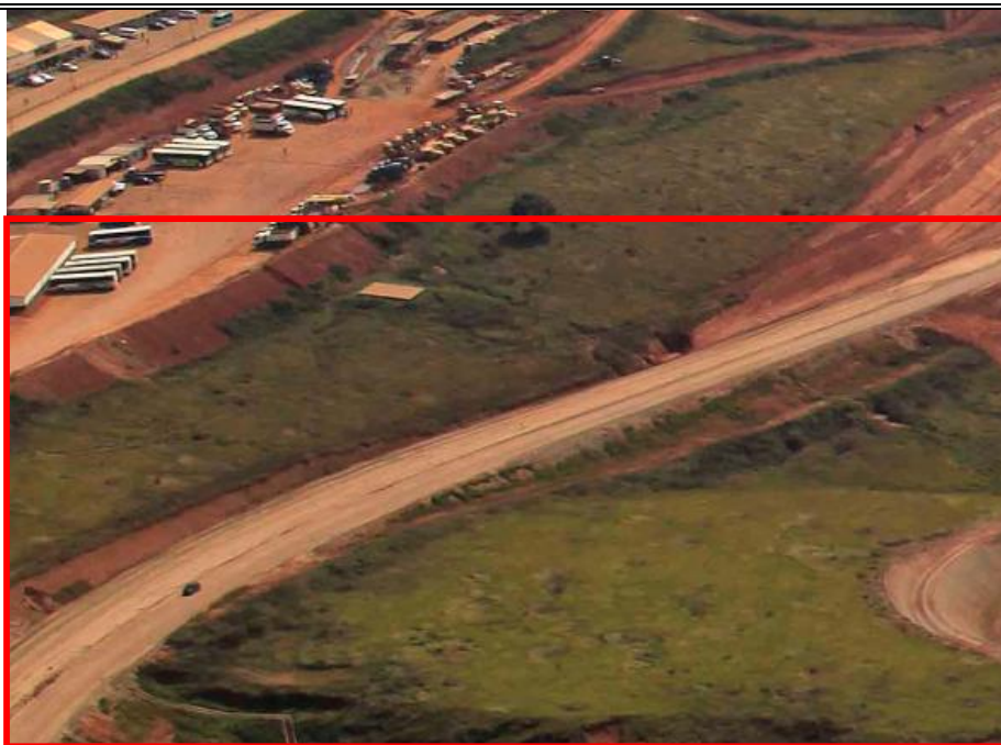
FOTO 06 OUTRO DETALHE MOSTRANDO TALUDES ANTES DA PAVIMENTAÇÃO DO ACESSO 1 PELA CONTRATANTE, NOTAR QUE JÁ HAVIA DANOS NO TALUDE.
