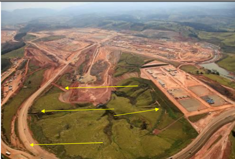
FOTO Nº 03 VISTA AEREA MOSTRANDO PROBLEMAS NOS TALUDES ANTES DA PAVIMENTAÇÃO DO ACESSO 1 PELA CONTRATANTE, TOMADA EM 2009.
