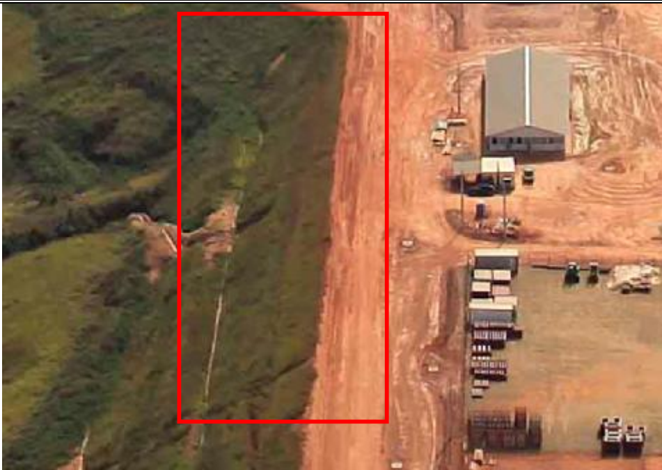
FOTO 05 OUTRO DETALHE MOSTRANDO TALUDES ANTES DA PAVIMENTAÇÃO DO ACESSO 1 PELA CONTRATANTE, NOTAR QUE JÁ HAVIA DANOS NO TALUDE.
