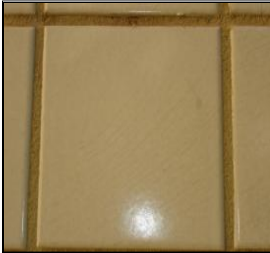
FOTO Nº. 10 – VISTA DE PEÇAS CERÂMICAS NA FACHADA LATERAL DIREITA. NOTAR GRETAMENTO, OU SEJA, FISSURAS CAPILARES SOBRE A SUPERFÍCIE VIDRADA DAS PEÇAS CERÂMICAS.
