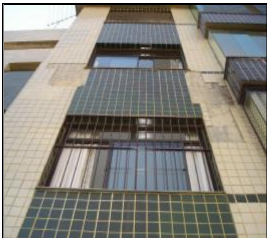
FOTO Nº. 13 – VISTA DA FACHADA LATERAL ESQUERDA. NOTAR DESPLACAMENTO JUNTO AO ENCONTRO DAS PLACAS DE CERÂMICAS DE TONALIDADES DIFERENTES.
