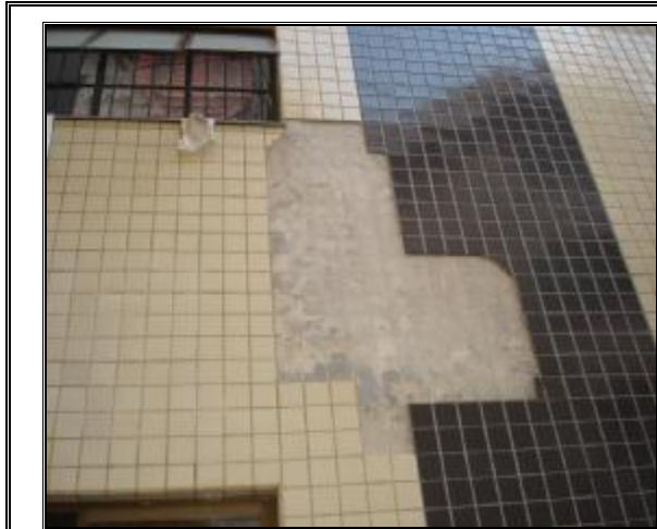
FOTO Nº. 07 – VISTA DA FACHADA LATERAL DIREITA DO PRÉDIO EM QUESTÃO. NOTAR DESPLACAMENTO JUNTO AO ENCONTRO DAS PLACAS DE CERÂMICAS DE TONALIDADES DIFERENTES.
