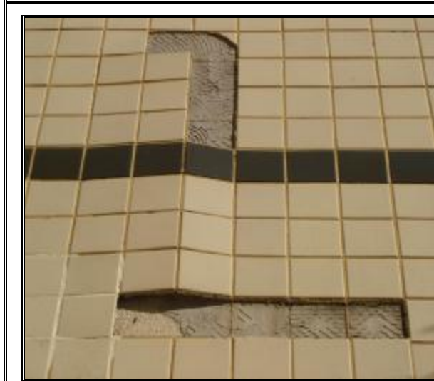
FOTO Nº. 08 – VISTA DA FACHADA LATERAL DIREITA DO PRÉDIO EM QUESTÃO. NOTAR DESPLACAMENTO CARACTERÍSTICO DE EXPANSÃO POR UMIDADE.
