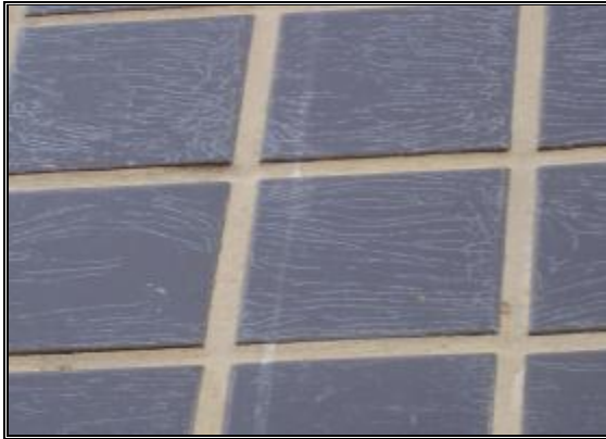
FOTO Nº. 18 – VISTA DE PEÇAS CERÂMICAS NA FACHADA LATERAL ESQUERDA. NOTAR GRETAMENTO, OU SEJA, FISSURAS CAPILARES SOBRE A SUPERFÍCIE VIDRADA DAS PEÇAS CERÂMICAS APLICADAS NO PRÉDIO.
