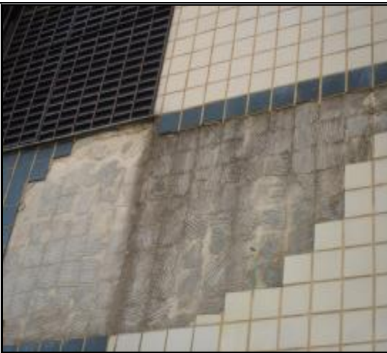
FOTO Nº. 16 – VISTA DA FACHADA LATERAL ESQUERDA. NOTAR DESPLACAMENTO COM ARGAMASSA COLANTE FIXA NO EMBOÇO, OU SEJA, O ROMPIMENTO DEU-SE NA INTERFACE CERÂMICA ARGAMASSA COLANTE.
