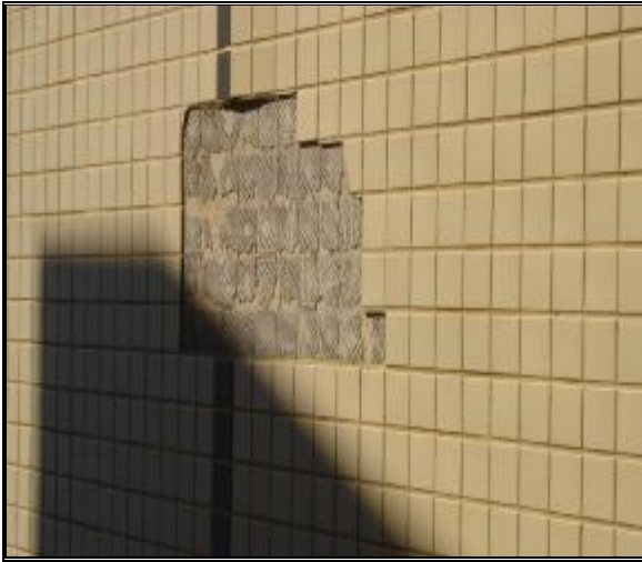
FOTOS Nº 09 – OUTRA VISTA DA FACHADA LATERAL DIREITA. NOTAR LOCAL ONDE OCORREU DESPLACAMENTO.
